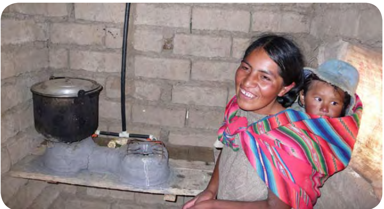
Figura 31: Las cocinas se pueden autoconstruir, acabando la conducción de biogás en tubería de ½” de hierro. De esta manera no hace falta fogón y la llama saldrá directamente de la tubería. Conviene siempre poner dos fogones. En la foto de arriba se ha seguido el esquema básico de un fogón principal y otro secundario, aunque aún falta por hacer la estructura de la cocina. En la segunda foto la cocina ya está funcionando y es de dos fogones equivalentes, dividiendo con una tee la conducción hacia ambas llaves y fogones.
