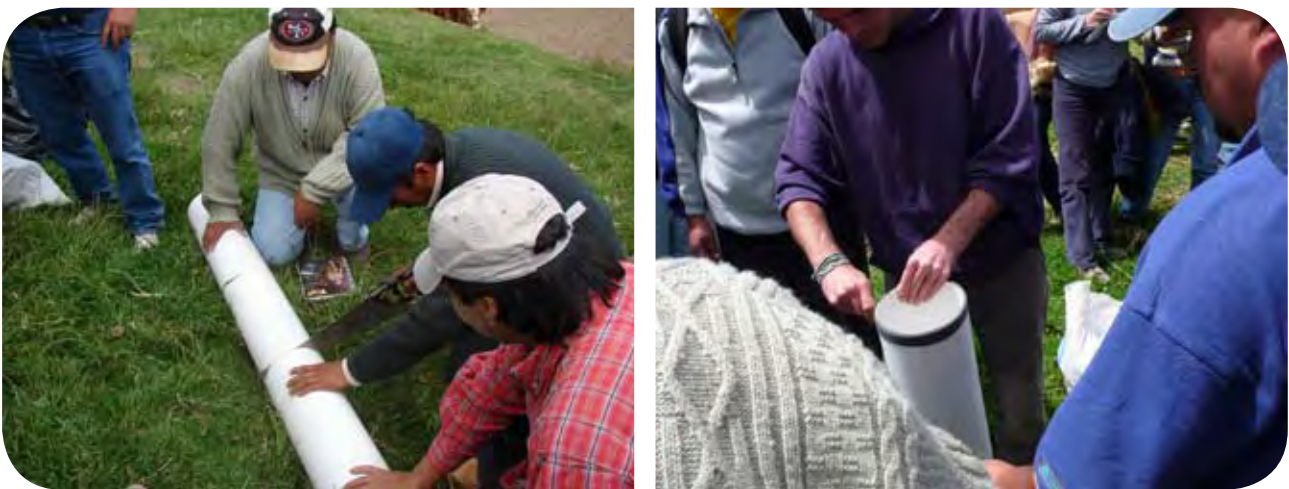
Figura 17: Las tuberías de entrada y salida son de PVC de 6” de diámetro. Normalmente se compra un tubo de 4 m, que hay que cortar en cuatro piezas de un metro cada una. Hay que proteger las bocas del tubo de entrada y el de salida que van a estar dentro del biodigestor. Amarrando liga neumática sobre el canto es suficiente.
