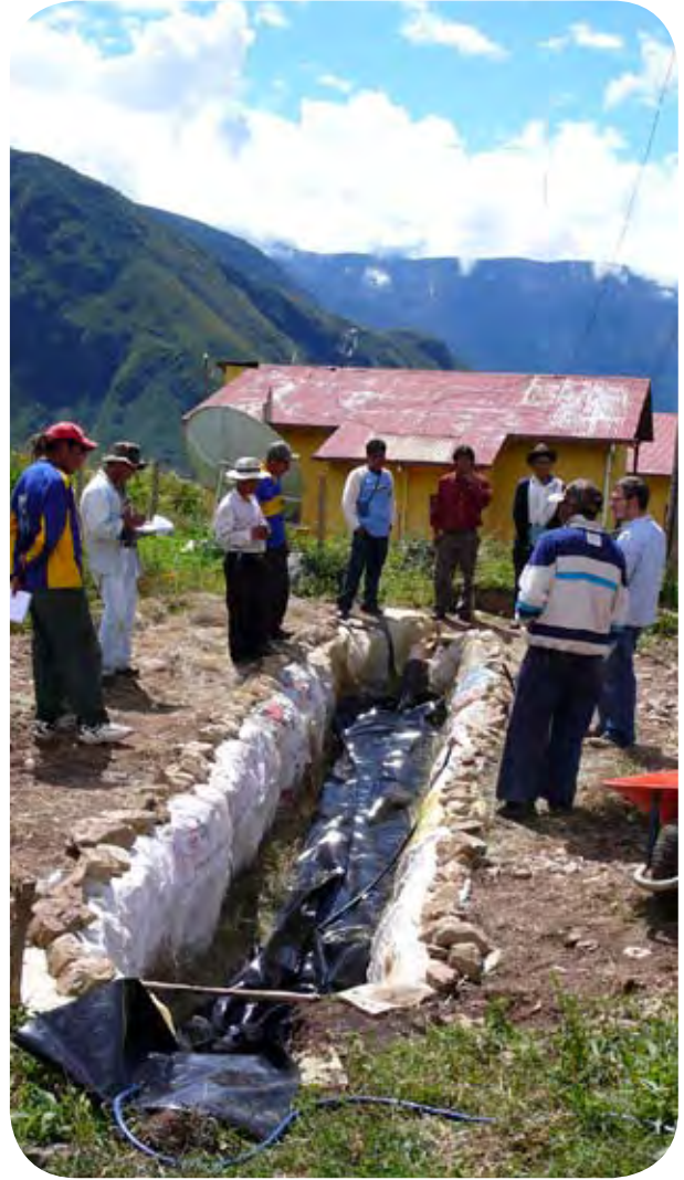
Figura 23: Biodigestor ya instalado, y empezando a ser cargado de agua y estiércol hasta que se tapan las bocas interiores de los tubos de entrada y salida.
