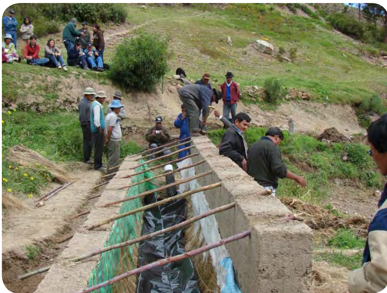
Figura 14: En el caso de biodigestores de altiplano, es necesario construir dos tapiales de adobe de unos 40 cm de grosor. Estos tapiales servirán de base para la carpa solar.
