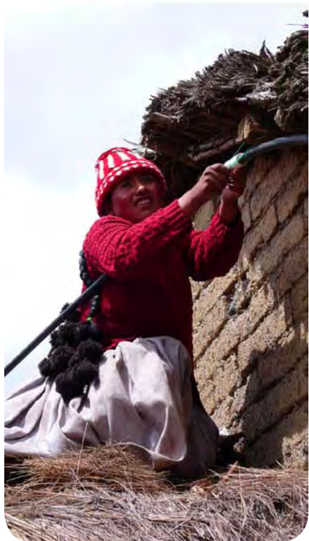
Figura 26: La conducción de biogás se hace con tubería de riego (politubo, tubería PED, tubería de pvc) de ½”, se usan los accesorios comunes, siempre con rosca.
